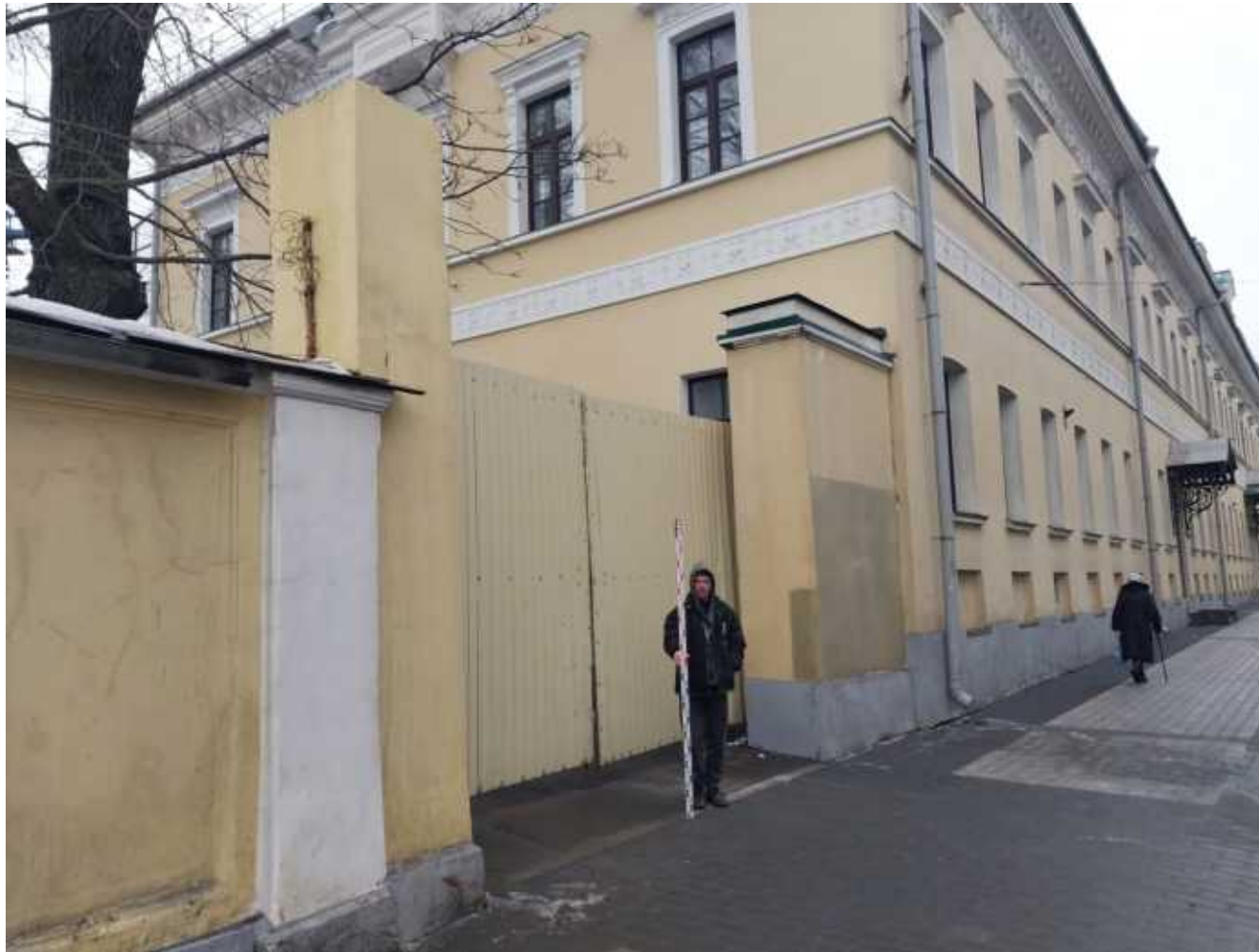
Илл. 22. Нижегородская область, г. Нижний Новгород, ул. Варварская, д. 3, работы по сохранению объекта культурного наследия федерального значения «Дом, в котором в разные годы бывали революционеры Лопатин Герман Алексеевич, просветитель Ульянов Илья Николаевич, композитор Балакирев Милий Алексеевич», приспособление к современному использованию въездных ворот, примыкающих к северной части фасада - 2025 г.
